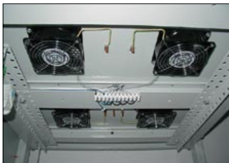
Rys. 4. Wentylatory zamontowane w pokrywie dachowej
